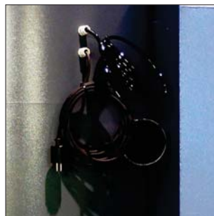
230V-Stromkabel mit Stecker und ø8mm-Druckluftschlauch ist an Vorderseite der Anlage vorhanden.
